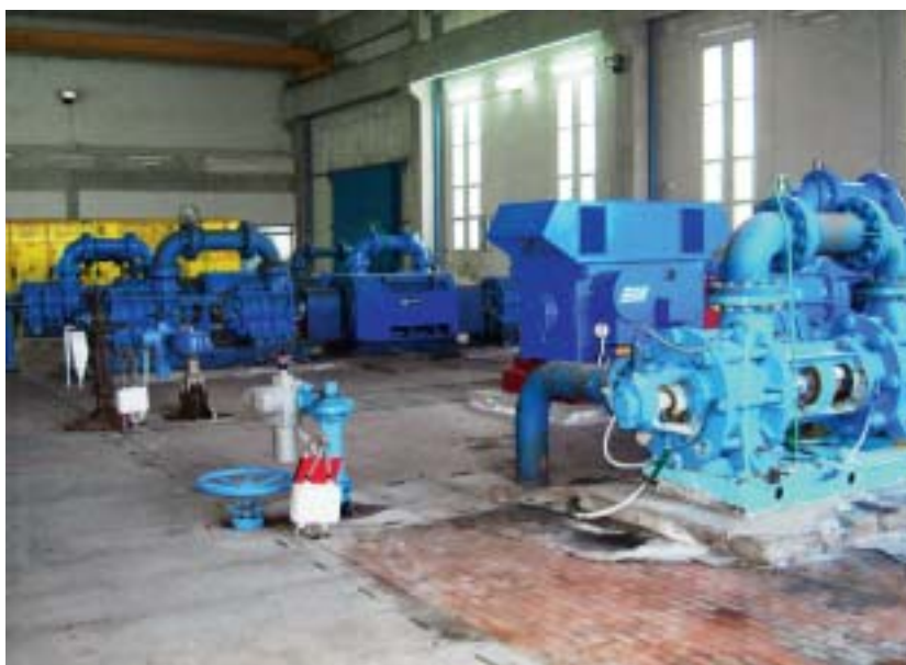
FIGURA 3.1: SALA MACCHINE IMPIANTO SOLLEVAMENTO AGGIA
