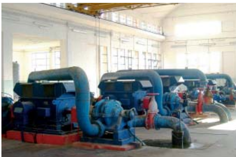
FIGURA 3.2: SALA MACCHINE IMPIANTO SOLLEVAMENTO GINESTROLE
